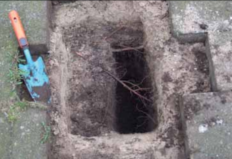
Opvullen wortelopdruk met koud asfalt. De ergste struikelproblemen zijn verholpen, maar na enkele jaren groeit de wortel boven het asfalt uit.
